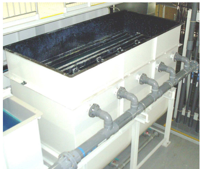
1540型 フロックセパレーター 設置例
