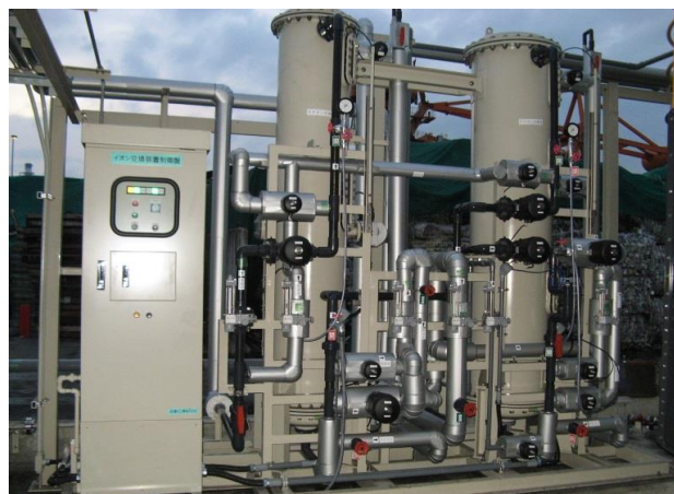
写真1 現地設備 ユニットの中央にカチオン交換塔を、その右にアニオン交換塔を配置
